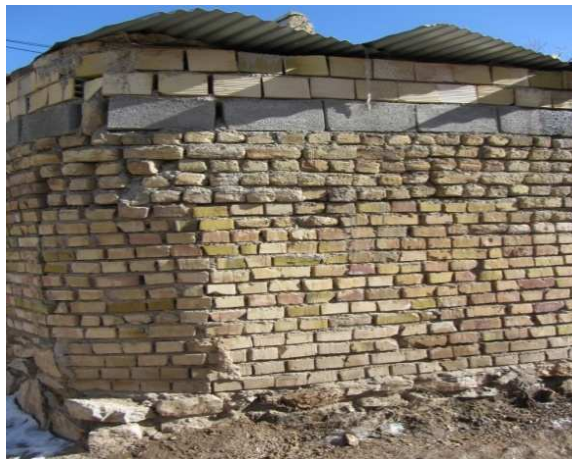
تصویر ۱: ترکیب سنگ، آجر، بلوک سیمانی، سفال در مسکن
